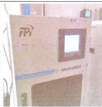
2. 总排口氨氮监测设备
