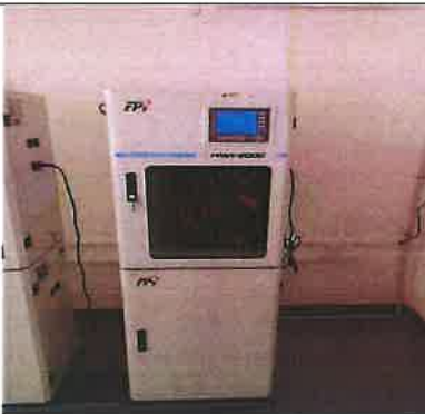
1. 设施排口总铅监测设备
