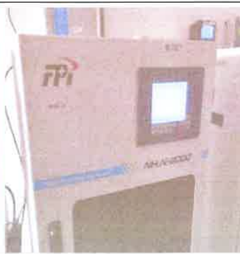
2. 总排口氨氮监测设备
